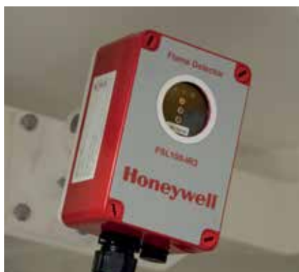
Rilevatore fiamma Flame detector
