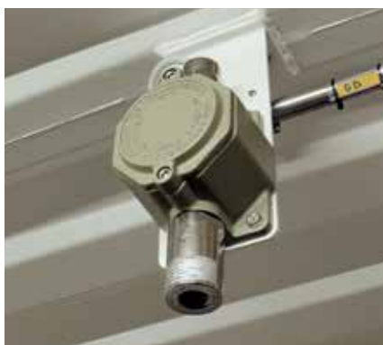
Rilevatore fughe gas Gas detector
