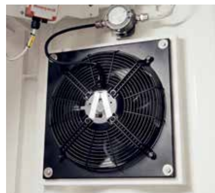
Sistema di ventilazione Ventilation system
