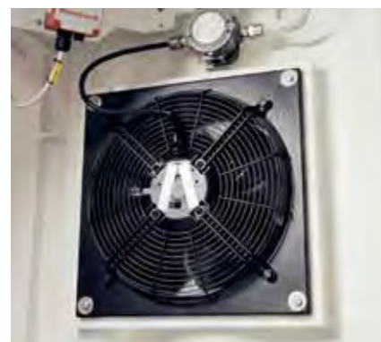
Sistema di ventilazione Ventilation system
