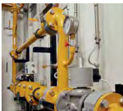
Linea di misura Metering system
