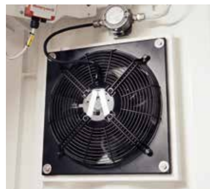
Sistema di ventilazione Ventilation system
