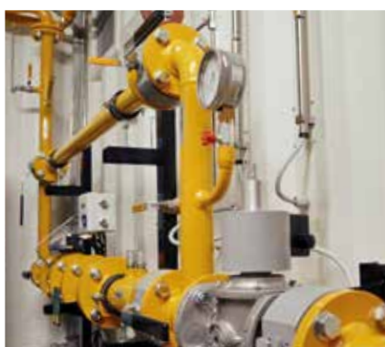
Linea di misura Metering system
